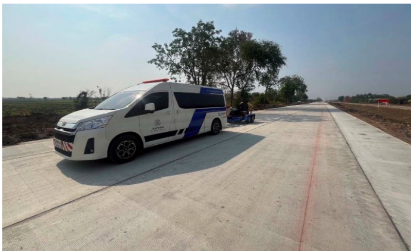
ภาพที่ 40 ภาพถ่ายโครงการก่อสร้าง บริเวณจุดที่ทำการทดสอบ
